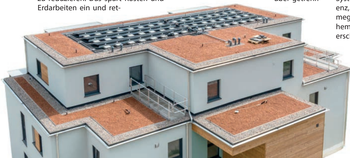
Doppelter Nutzen: 48 Photovoltaik-Thermie-Module der TWL-Technologie liefern elektrischen Strom und thermische Energie.
