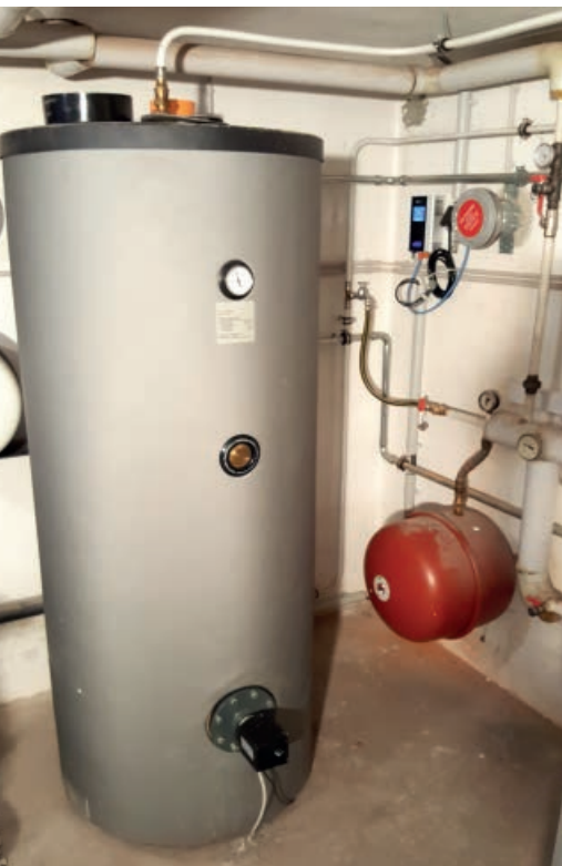
Ein Warmwasserspeicher mit einem Heizstab, der stufenlos von einem AC Thor angesteuert wird: So einfach ist solarelektrische Haustechnik. Foto: my-PV
