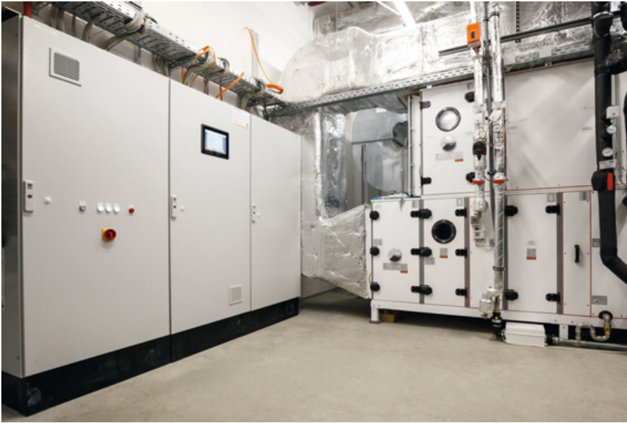
Herzstück der MSR-Technik ist der neu eingerichtete Automationsschwerpunkt ASP12 in der Lüftungszentrale mit der Raumluftheizungsanlage. Auf den hier installierten DDC4000 liegen die Lüftungsregelung, die verschiedenen Brandabschnitte sowie die Schnittstelle zur Showtechnik und zu den Umluftkonvektoren.
