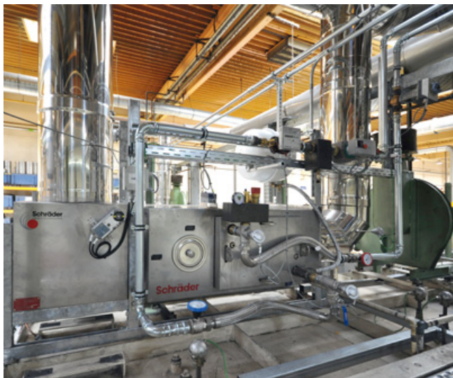
Die Abgaswärmetauscher von Schröder wurden bei Bulten auf den Härteöfen montiert und in die Abgasstrecke eingebunden.
