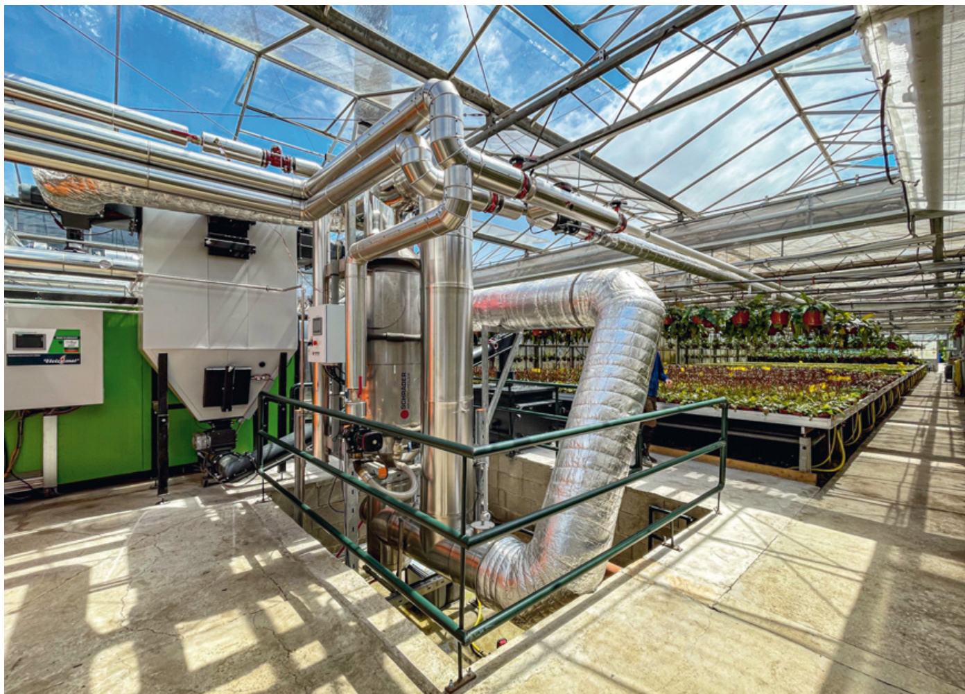
Effiziente Wärmerückgewinnung von Schröder für den Gartenbaubetrieb Weillbrenner: Hackgutheizung und Wärmetauscher stehen im Gewächshaus. Alle Fotos: Schröder Abgastechnik, Kamen
