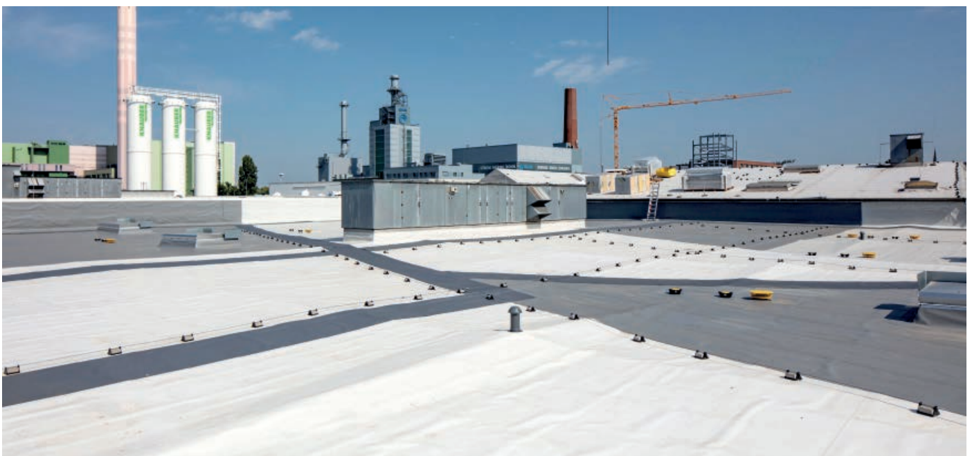
Die Sanierung wurde auf 2 Jahre angesetzt. Sechs der acht Teilflächen sind bereits fertig.
