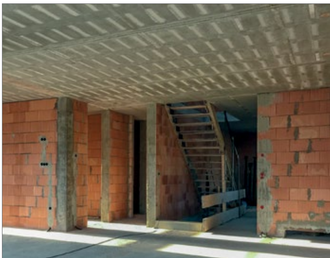
Die später im Raum „unsichtbare“ Klimadecke dient als Strahlungsheizkörper, zur Kühlung, als Energiespeicher und teilweise auch dem Schallschutz.
