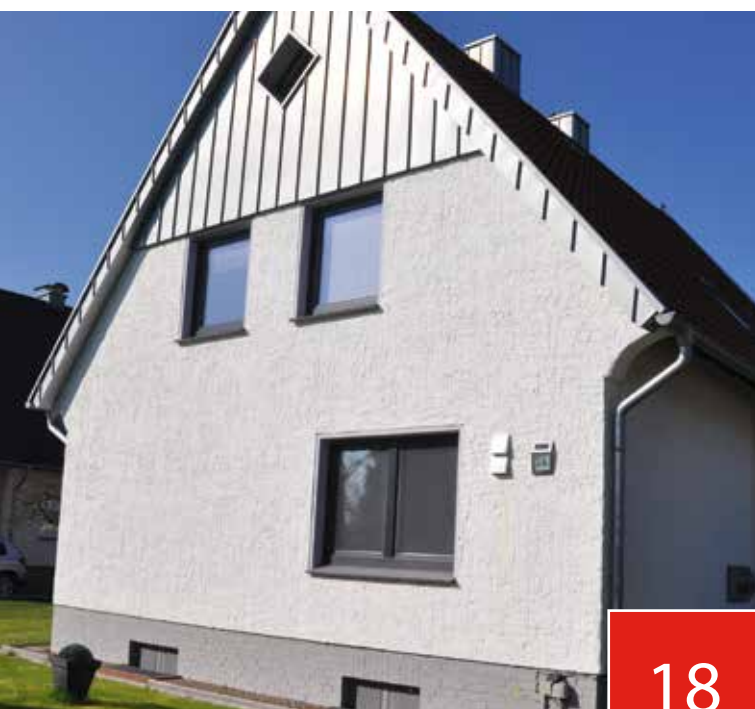
Automatisch lüften – Schimmel vorbeugen
