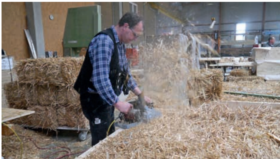
Die Wandelemente wurden in der Zimmerei vorgefertigt, die Strohballen eingepast und abgeholt.
