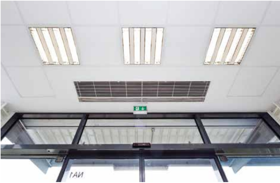
Die Türluftschleieranlage im Eingangsbereich sorgt dafür, dass ein energieintensiver Luftaustausch zwischen Außen- und Innenbereich nachhaltig verhindert wird.
