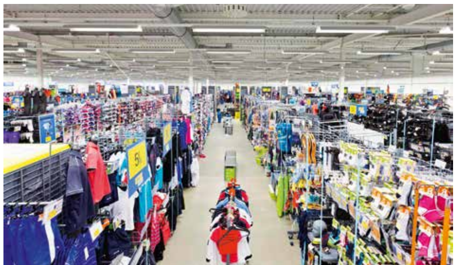
Die Verteilung der vorkonditionierten Luft erfolgt ganz typisch für Verkaufsmärkte dieser Art über Wickelfalzrohre und entsprechende Tellerventile.
